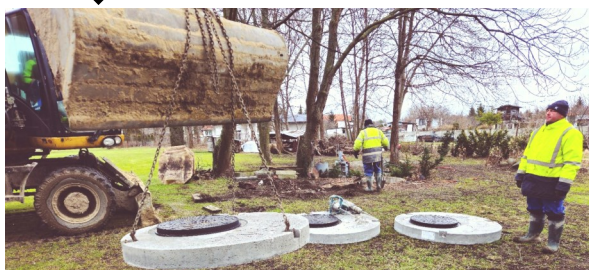
Zbiorniki na deszczówkę wyglądają znacznie estetyczniej dzięki instalacji nowych pokryw.
