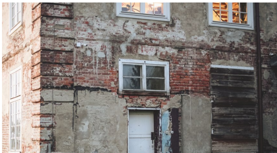
Z Bożą pomocą w niedługim czasie budynek dworu przestanie straszyć oknami zabitymi deskami
